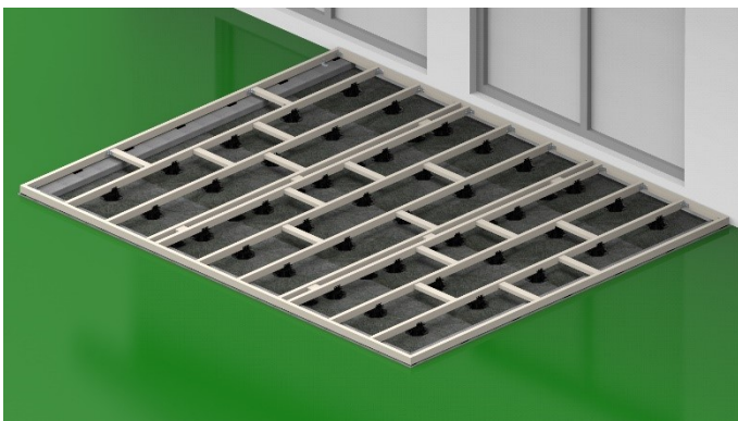
14. Wenn alle Unterkonstruktionen an der Rahmenkonstruktion angeschraubt worden sind, können die Verstellfüße exakt ausgerichtet werden.
